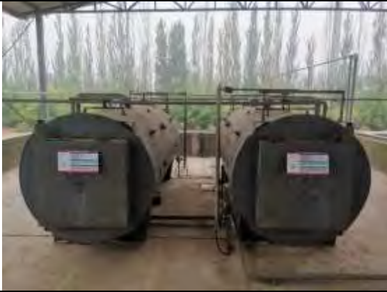
二氯甲烷储罐围堰
