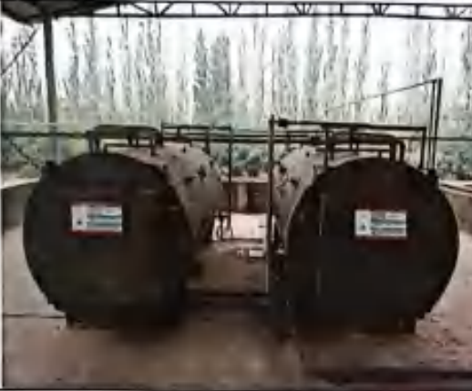
二氯甲烷储罐围堰
