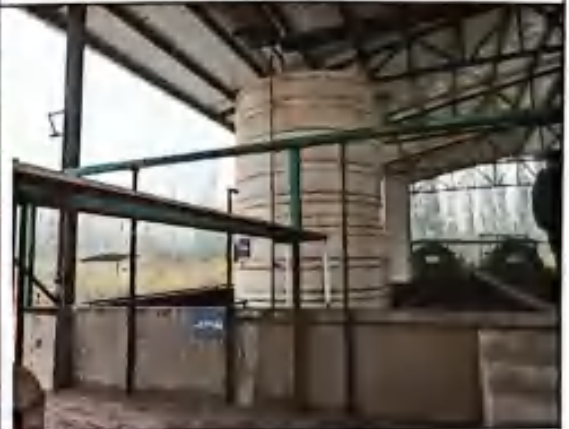
盐酸储罐围堰
