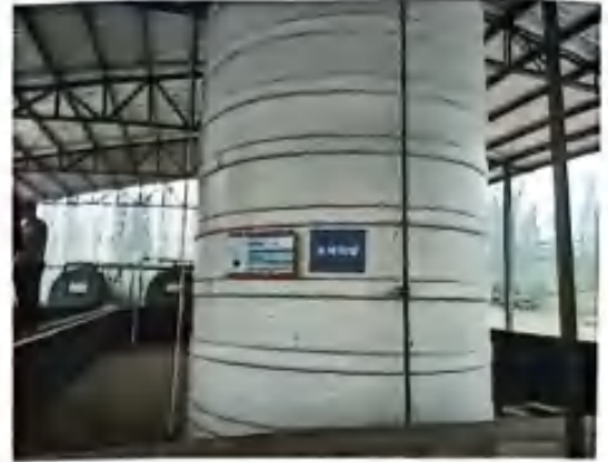
液碱储罐围堰
